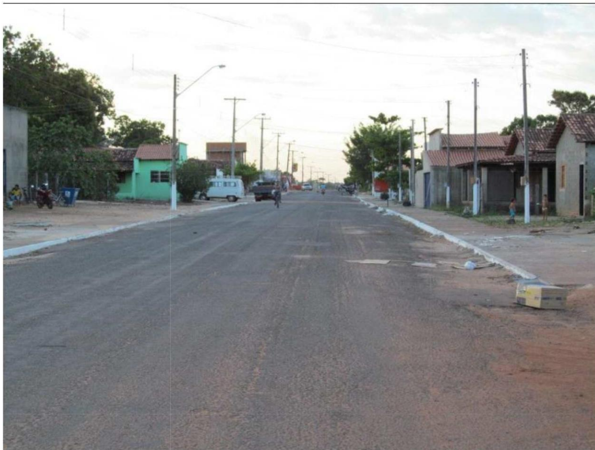
Foto: Ausência de sistemas de drenagem.
